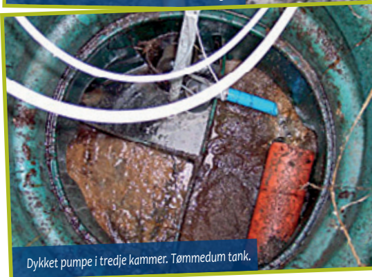
Opføringsrør på bundfældningstank beskadiget.
