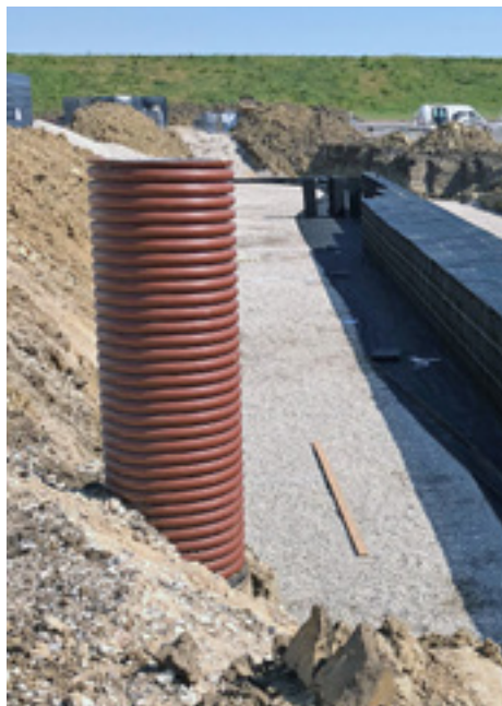
Der bygges nye boliger i Greve, og dermed skal der tages seriøs stilling til reguleringen af regnvandet. Løsningen er de mange præsamlede regnvandskassetter.
